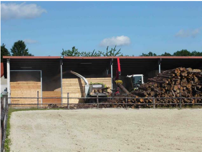
Bestückung des Hackschnitzelbunkers.
